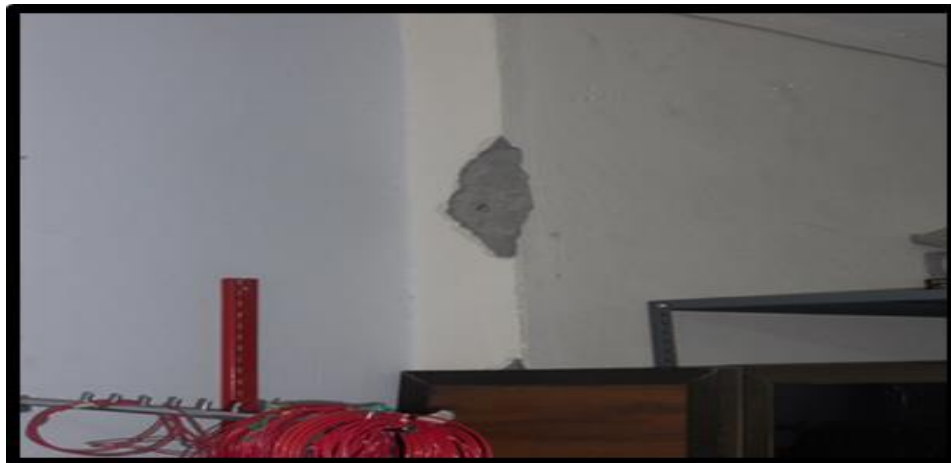
Figura 7. Riesgo locativo en la empresa Punto Eléctrico.
