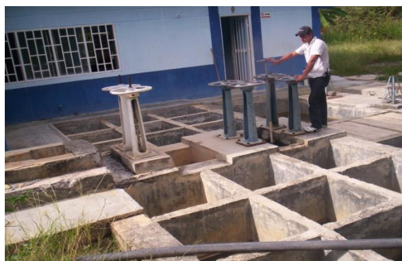
Figura 5. Planta de tratamiento del agua.
