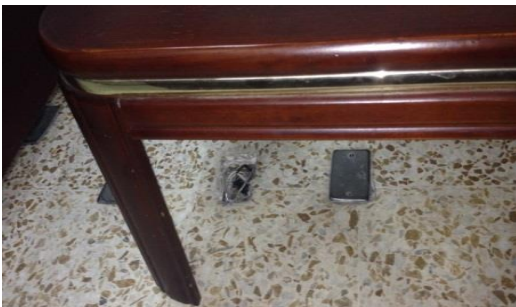
Figura 3. Deficiencia en instalaciones Eléctricas Cables eléctricos expuestos
