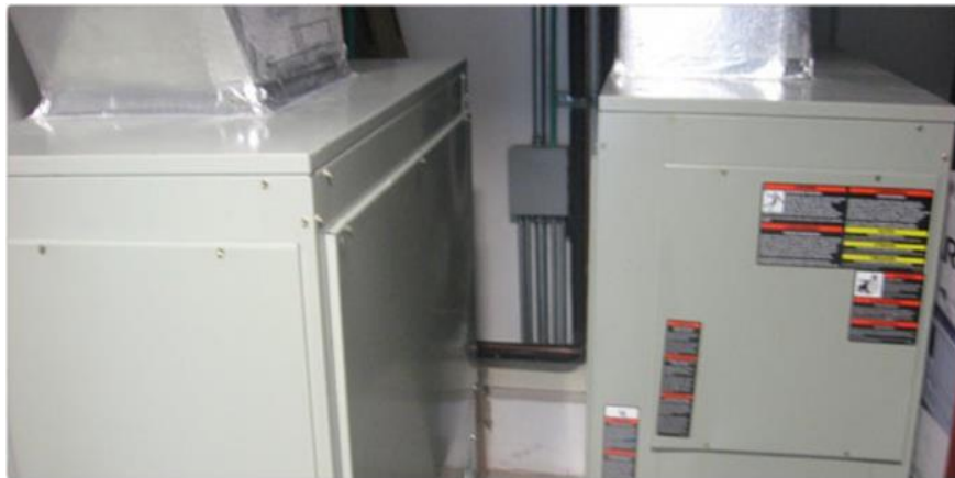
Imagen 2. Sistemas de ventilación, extracción.
